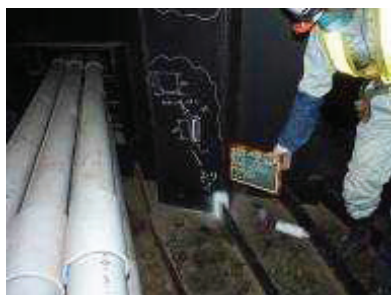
Longitudinal rib crack
