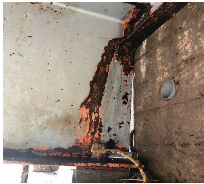
Corrosion of girder edge
